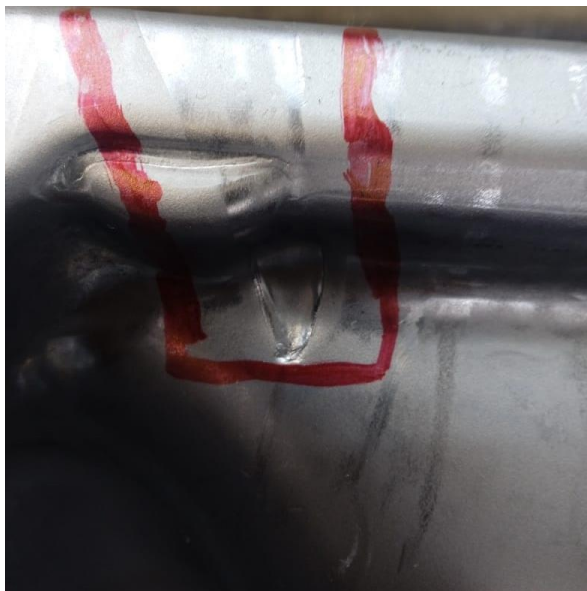
Imagen 23 Adelgazamiento en zona de coronilla
