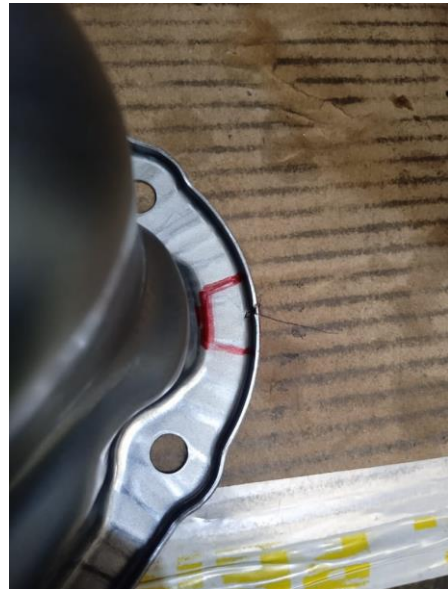
Imagen 22 Grieta en zona de coronilla
